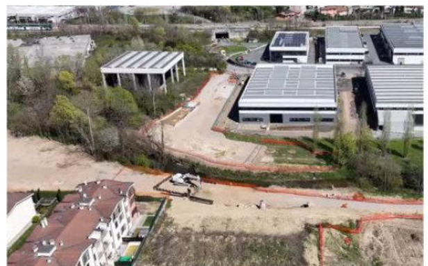
ATTIVITÀ DI INFISSIONE PALANCOLE SULLA SPALLA A DEL PONTE IN VIA PRATI
